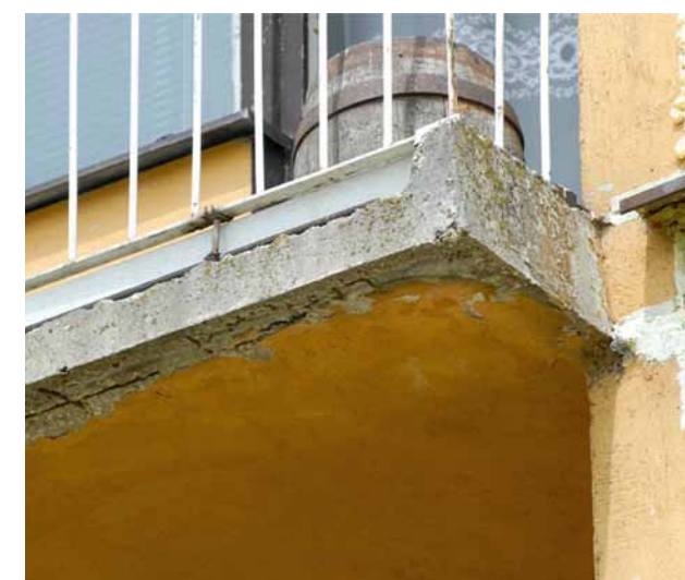
Betona atdalīšanās no balkona malām.
