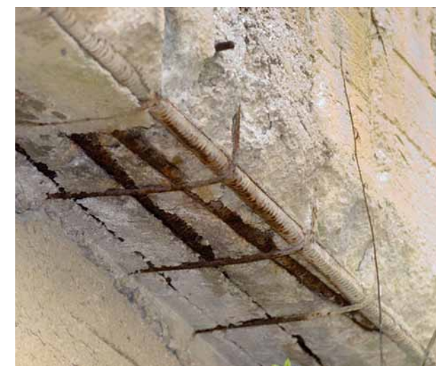
Betona atdalīšanās no korodējošā armējuma.
