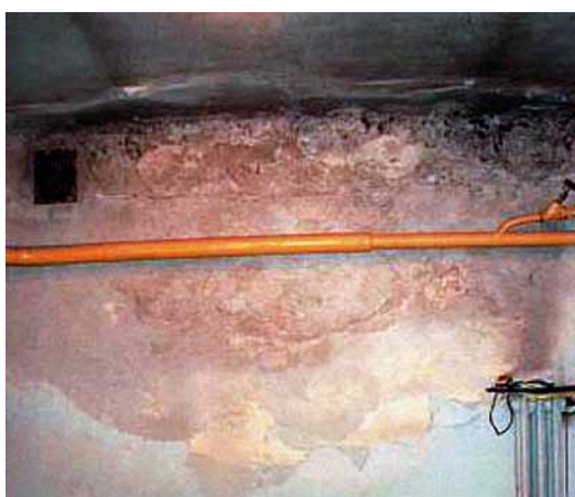
Krāsas pārklājuma, apmetuma un krāsas sabrukums stipra mitruma zonā (ūdens pieplūdums no ārpuses – masīvs pamatu bloks).
