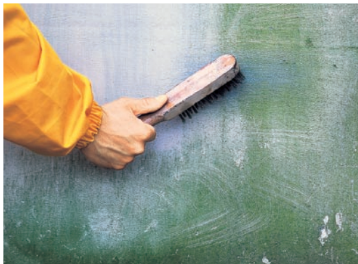
Pirms gruntēšanas pamatni attīra no vajējiem putekļiem
